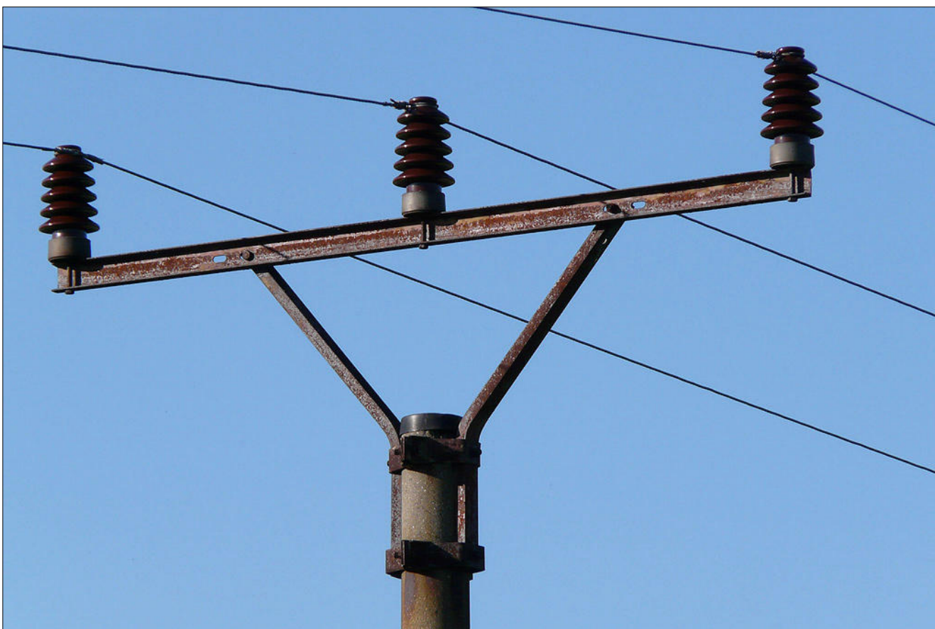
Obr.4 – Kovová konzola s hnědými izolátory
